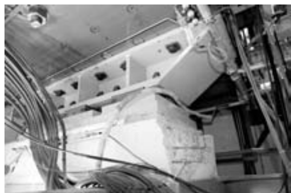
図2 サイクロトロン本体の支柱
